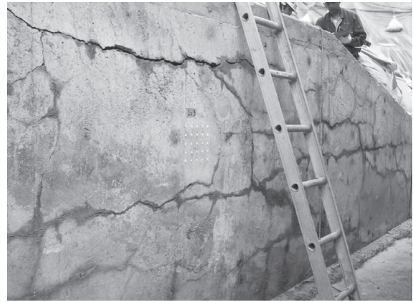
写真2 ASR によって劣化したコンクリート構造物
